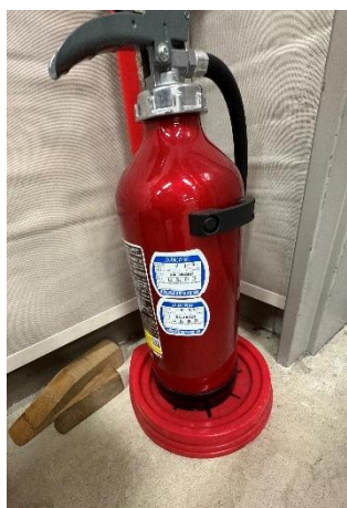
【消火器の点検済証の確認】
